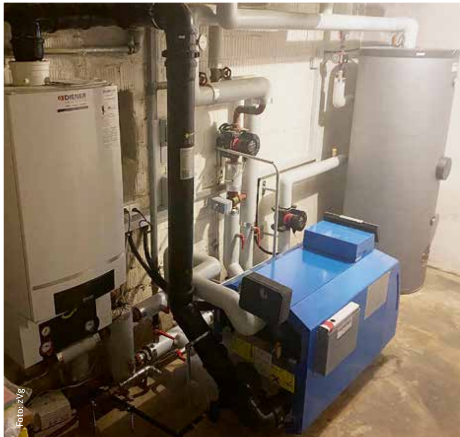
Die neue Ölheizung versorgt Bewohnerinnen und Bewohner mit wohliger und vor allem bezahlbarer Wärme. Links an der Wand zu sehen: die bestehende Gasheizung.
